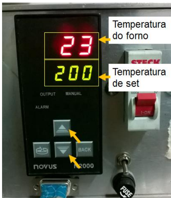
Figura 2.9. Display do modulo de potência.
